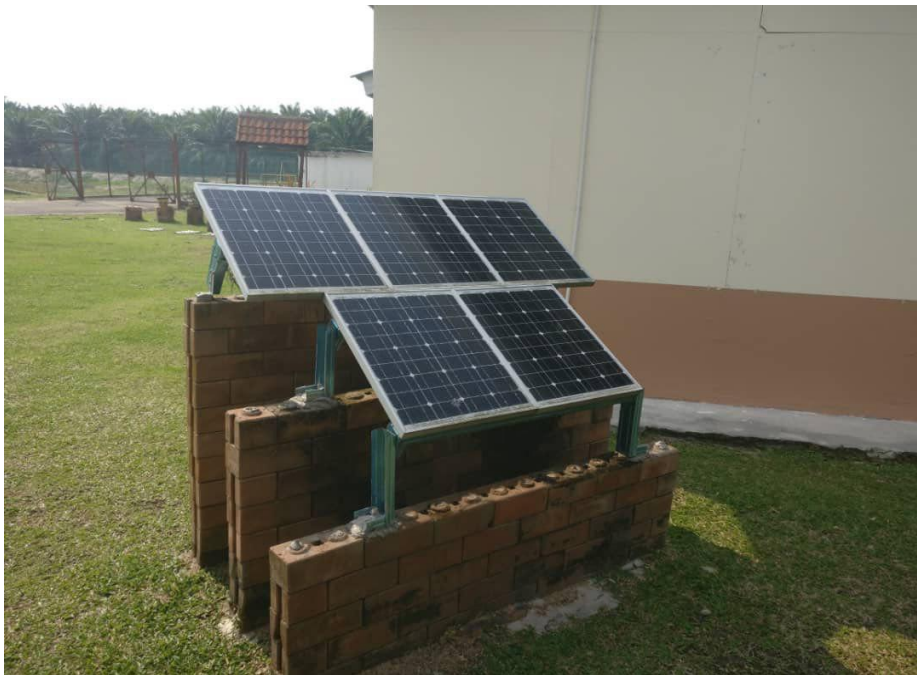
GAMBARFOTO UNIT PANEL SOLAR YANG DI PASANG DI RUMAH KOMUNITI @ KOLEJ KOMUNITI BENTONG
